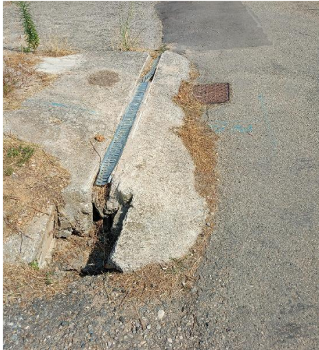
Le regard endommagé
