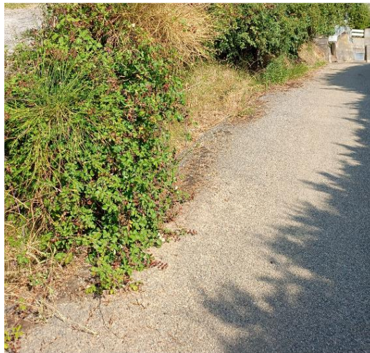
les ronces qui dépassent sur le chemin
