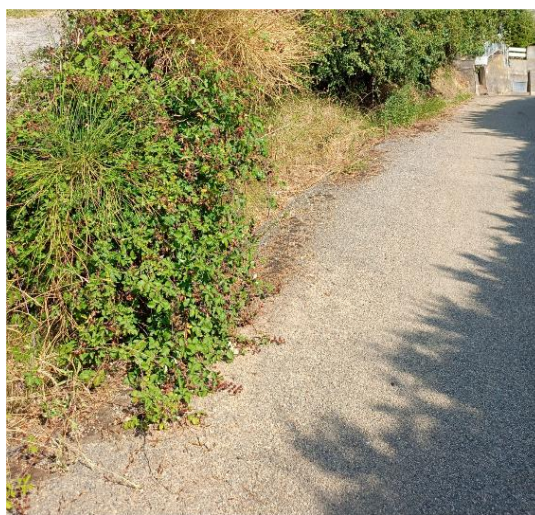
les ronces qui dépassent sur le chemin
