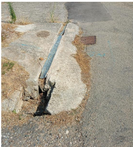
Le regard endommagé
